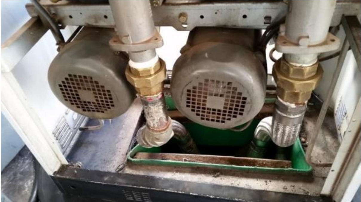
Figura 3 – Câmara de contenção de unidade abastecedora de Óleo Diesel com bordas soltas e com dimensões inapropriadas
