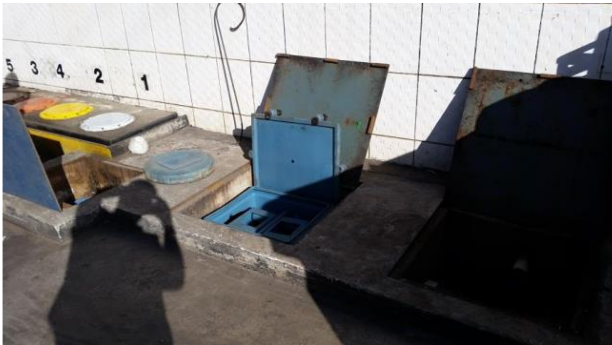
Figura 14 – Vista geral do SAO da pista de abastecimento
