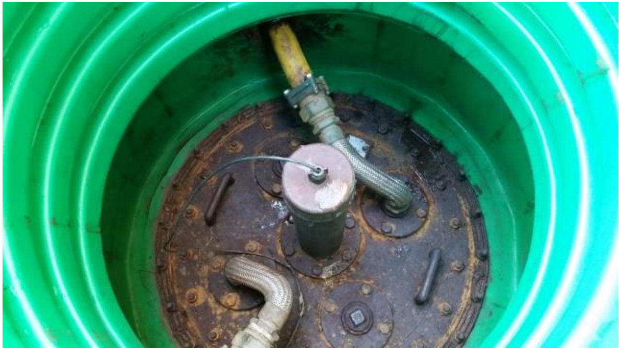
Figura 12 – Câmara de contenção da boca de visita do tanque. É possível visualizar a fiação do sistema de controle eletrônico de estoque
