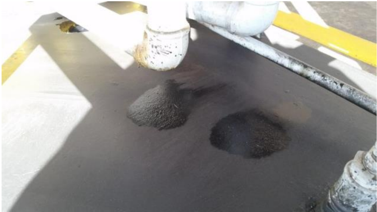
Figura 6 – Filtro de Diesel com sinais de gotejamento
