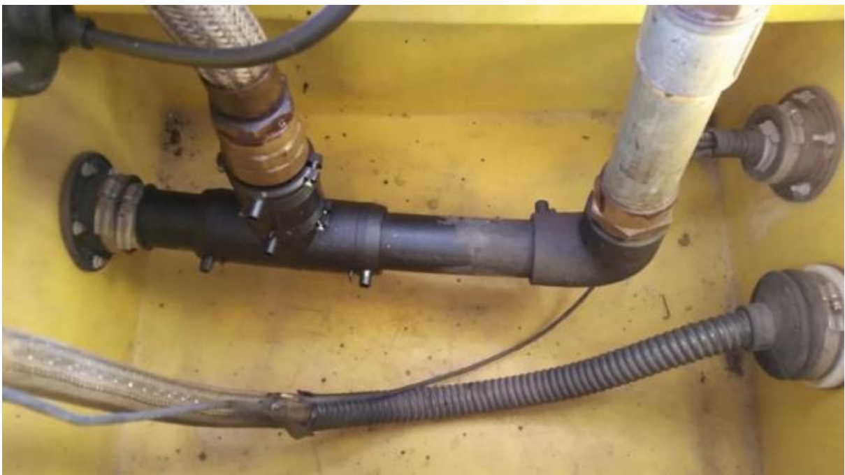
Figura 4 – Câmara de Contenção do filtro de Diesel instalada corretamente e com manutenção adequada
